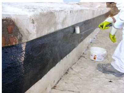
Installazione dello strato di rinforzo in fibra di carbonio FIDCARBON UNIDIR 320 HT 240.
