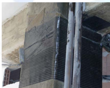
Fasciatura del pilastro tramite tessuto in fibra di carbonio FIDCARBON UNIDIR 320 HS 240.
