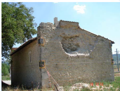
Zona fortemente lesionata con conseguente crollo di parte della muratura.
